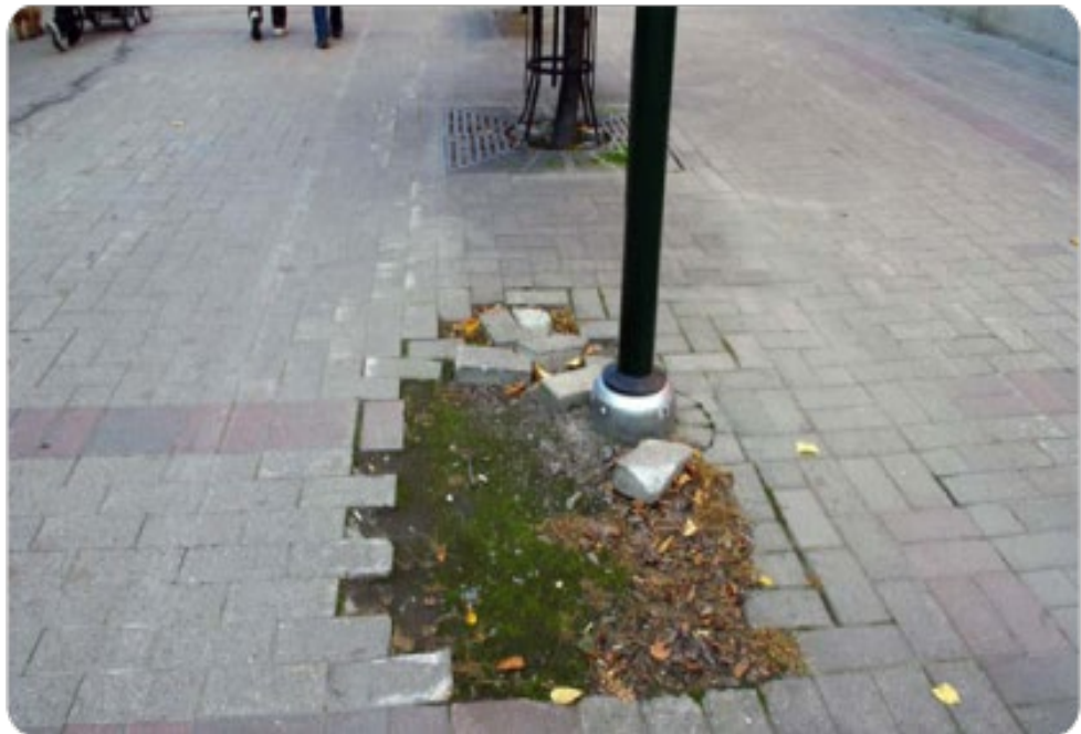
Kuvat 82 ja 83: Päälysteellä voidaan luoda ilmeikstä pintaa. Korjaamaton päälysteaurio antaa epäsiistin vaikutelman ja on tapaturmariski.
